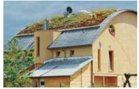
Joskus kyseessä on rakenteellinen muotoilu, kuten tässä esimerkissä (erittäin kalteva matalampi kattopinta) joka johtaa siihen että kahta eri "pinnoitetta" käytetään samassa rakennuksessa.
