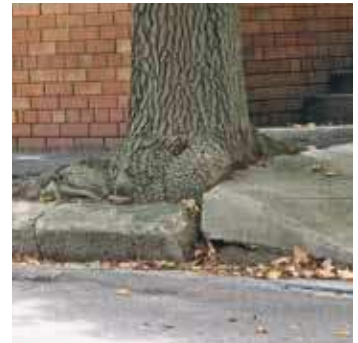
VÄLTÄ JUURIEN AIHEUTTAMIA VAURIOITA
